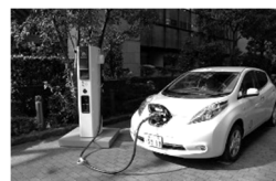
(急速充電設備)
